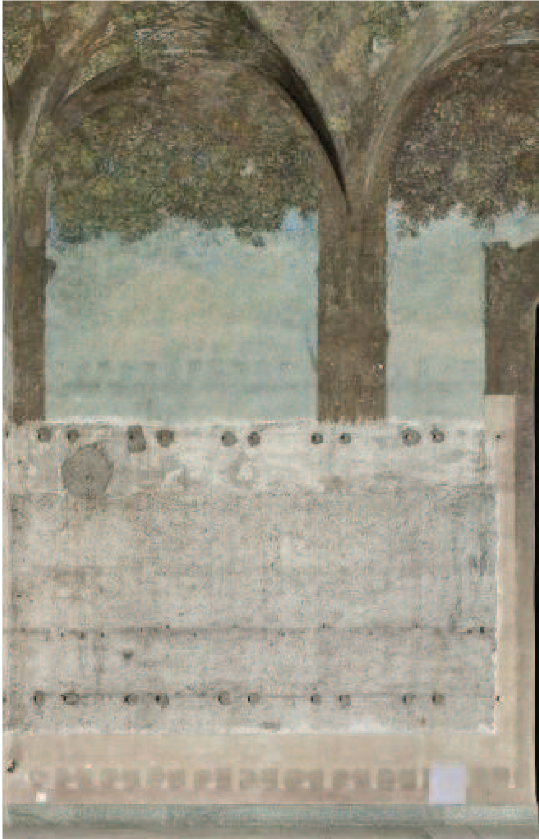
FIG. 3 - Leonardo da Vinci (attr.), Decorazione murale della Sala delle Asse , Particolare della parte bassa della parete dopo lo smontaggio dell'allestimento BBPR del quale sono ancora presenti i perni di aggancio alla parete. Sono visibili anche i punti di attacco alla parete della spalliera degli stalli lignei di Beltrami. Milano, Castello Sforzesco, Sala delle Asse
